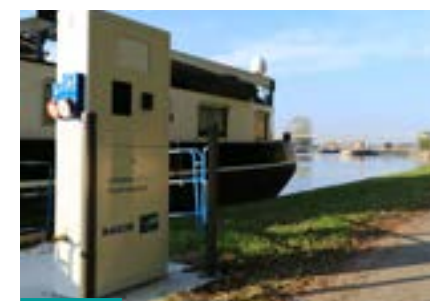
Borne eau/électricité à Amfreville
