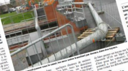
Faute de pouvoir passer sous le canal, les eaux usées sont traitées par des pompes dans des tuyaux.
